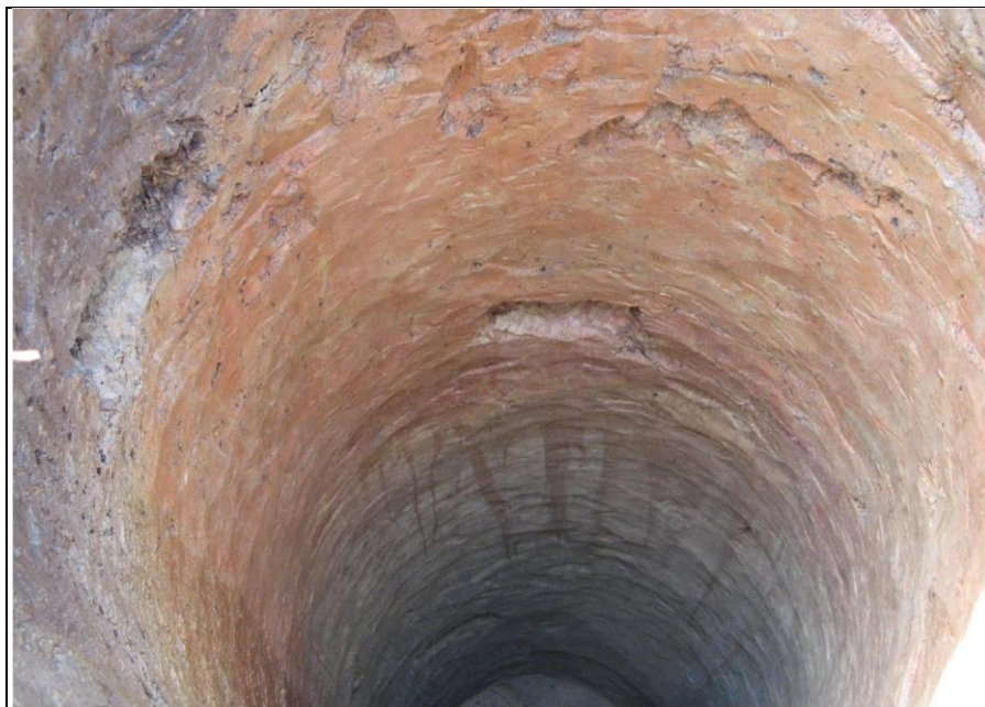
Foto 2 - Evidencia de afloramiento de aguas infiltradas superficialmente
