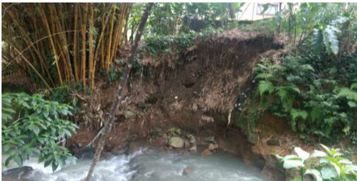
Imagen 2. Socavación en la margen derecha de la quebrada La Presidenta. CVG Servicios Ambientales. 2019.
