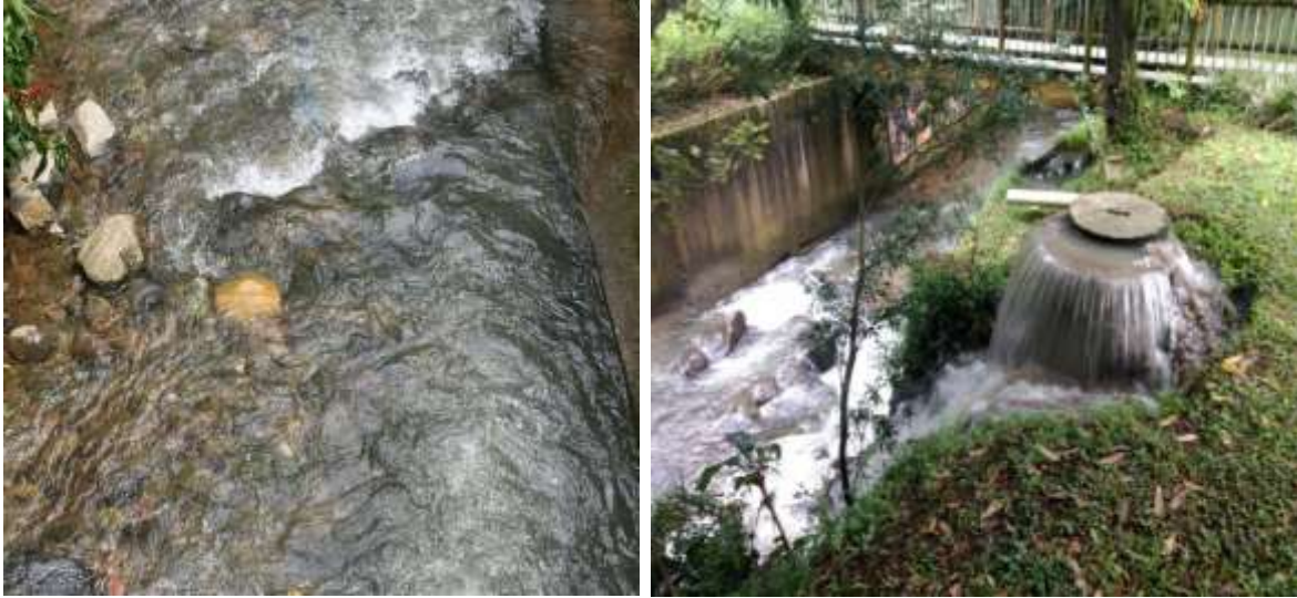
Imagen 13. Falla del sistema de alcantarillado público y afectación a la quebrada La Presidenta. Fuente: CVG Servicios Ambientales, 2019.
