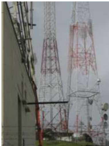
Foto 9 Emplazamiento de telecomunicaciones
