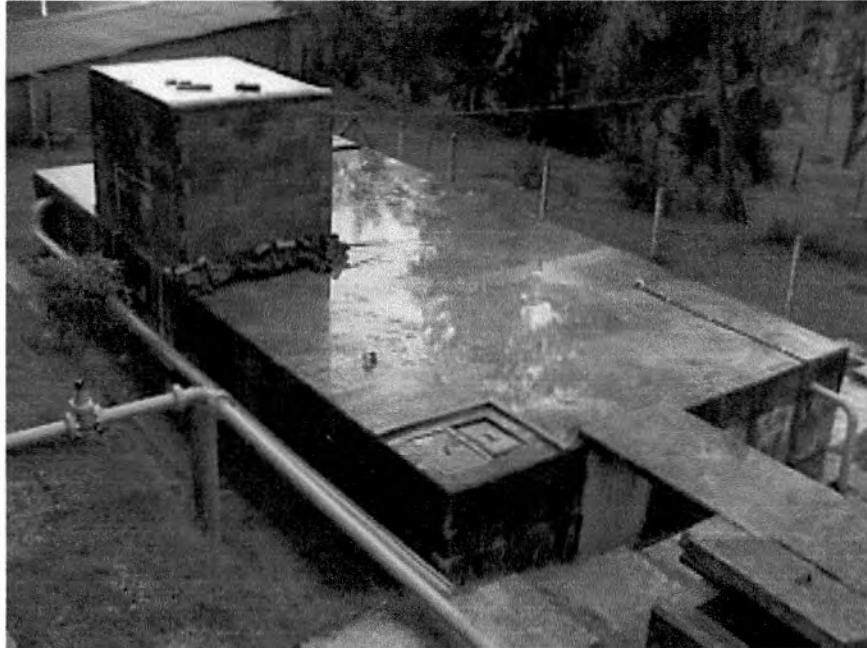
Tanque de almacenamiento del acueducto Multiveredal Plan-Llano
