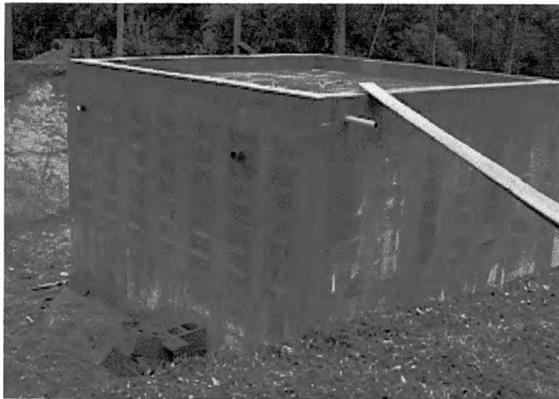
Nuevo tanque de almacenamiento contiguo a la planta de tratamiento. Acueducto de Mazo
