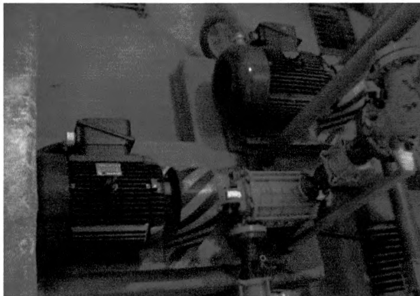
Bombeo del acueducto Multiveredal Plan-Llano
